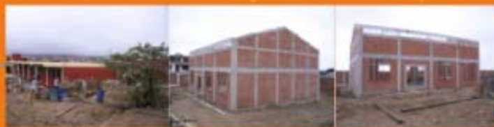
1- Colegio Elías Aguirre de VES, ganador del primer puesto en el 2005 en la Categoría A, en plena ejecución de obras en sus instalaciones, como parte del premio de Cementos Lima.
